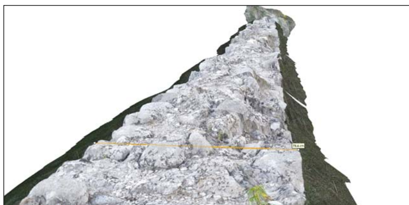
Εικόνα 14 – 3Δ μοντέλο του κατεστραμμένου τμήματος της υδατογέφυρας (παρατηρείται η ευκολία μέτρησης του πλάτους της στο περιβάλλον του λογισμικού Agisoft)
